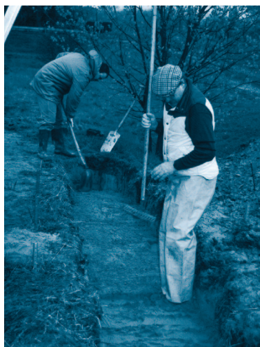
slechte verdichting met de voeten
